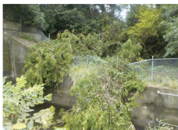
(香取市 本矢作地先 北部幹線用水路の倒木)
