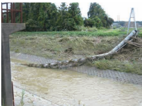
(茂原市 墨田地先 県営両総五郷支線用水路の水管橋崩落)
